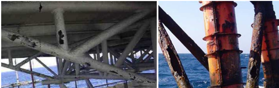
Fig.18 e 19 - Corrosão na jacket; fonte: EL-Reedy pág. 524 e 555
