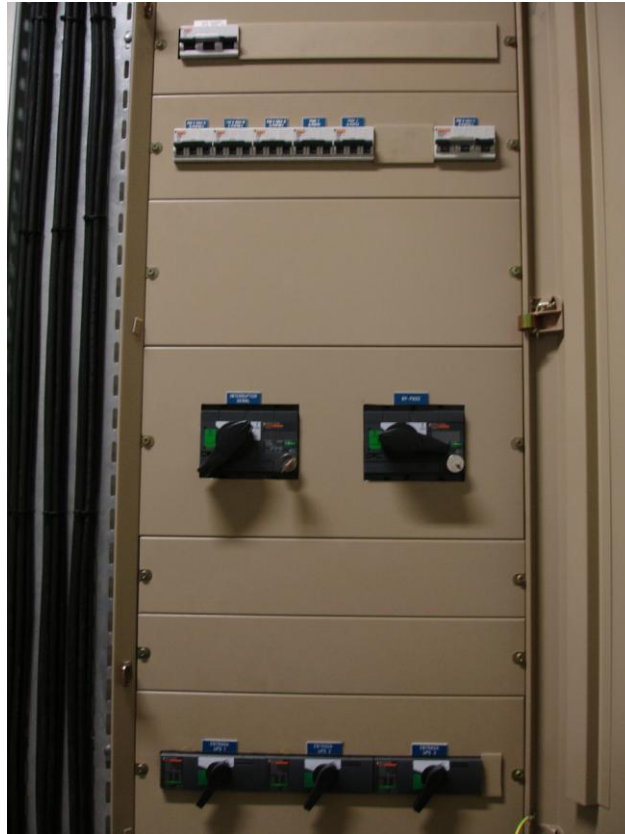
Figura 2.11 - Quadro das UPS
