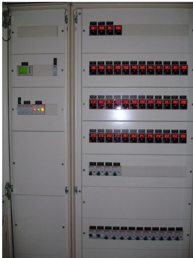
Figura 2.12 - Exemplo de Quadro da Sala de Servidores
