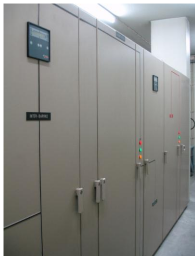
Figura 2.3 - Quadro Geral de Baixa Tensão
