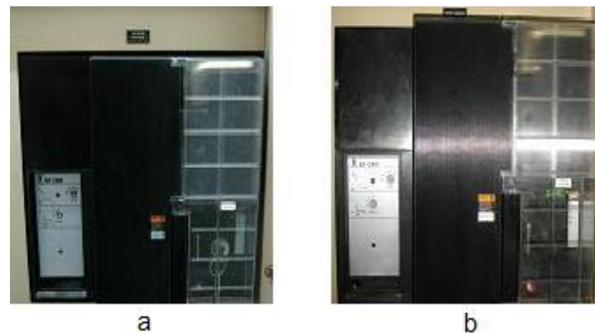
Figura 2.4 - Disjuntor de protecção do transformador (a) e Interbarras (b)
