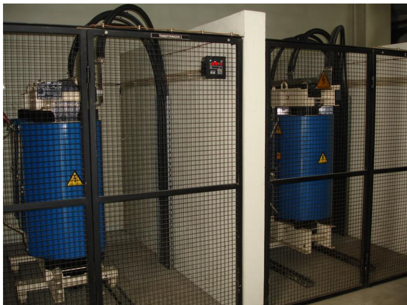
Figura 2.2 - Transformadores 1 e 2 do Posto de Transformação
