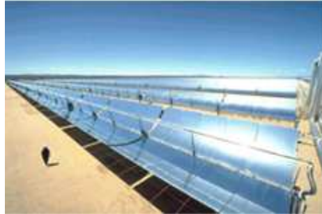
Figura 12312: Colectores solares cilindrico-parabólicos com 1 eixo de rotação
