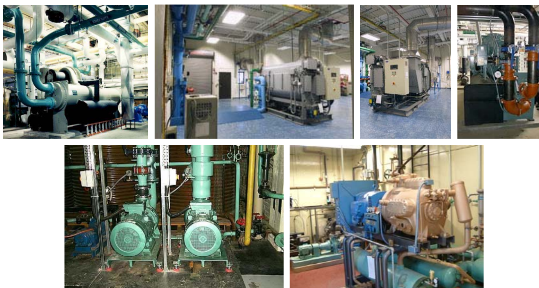
Fig.30 – Chillers de Absorção
