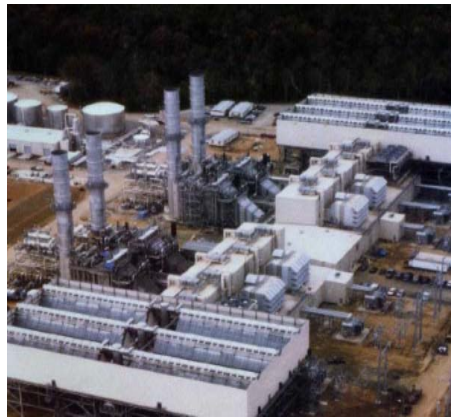
Fig.7 – Instalação industrial com quatro Turbinas a Gás (Virgínia - USA)
