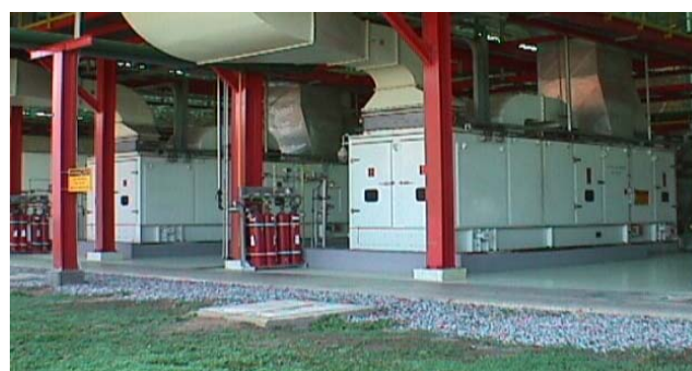
Fig.9 – Sistema de Turbinas a Gás (Fábrica de Cerveja Brahma -Brasil)
