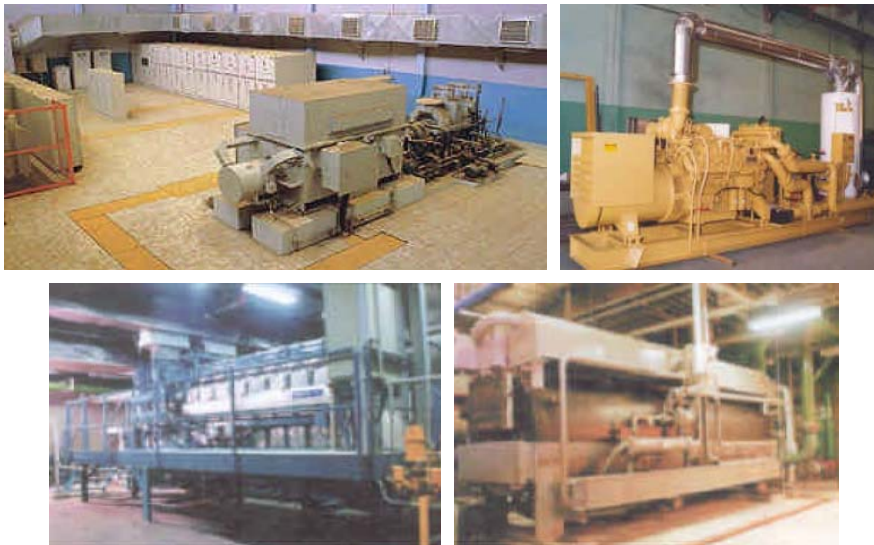
Fig.3 – Unidades de Cogeração utilizadas no Sector Terciário
