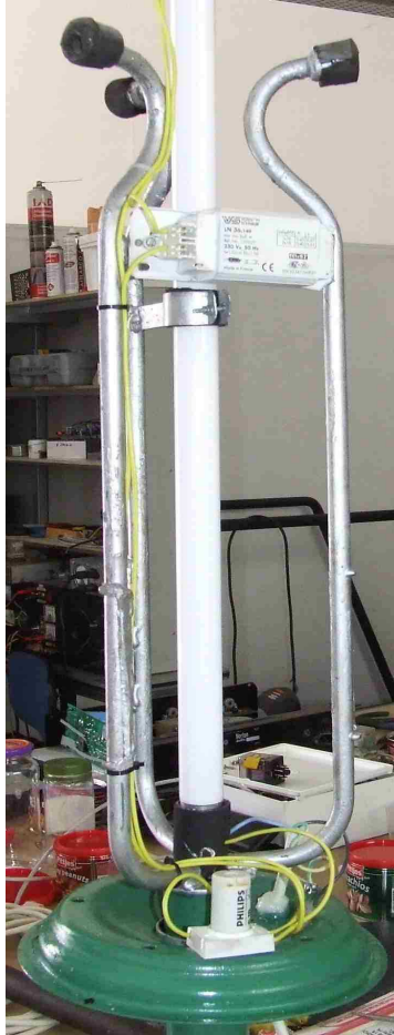
Imagem 7.17 - Candeeiro modernizado ainda sem tubo de revestimento em acrílico
